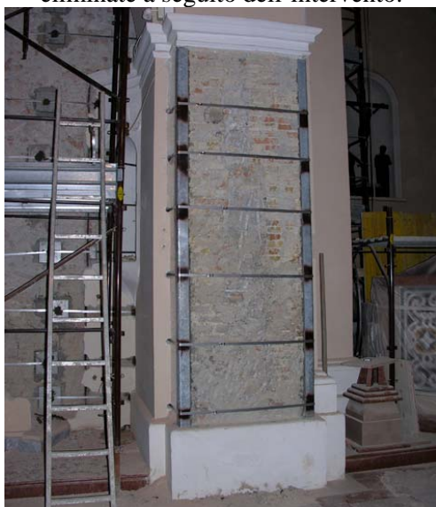
Fig. 5 – Applicazione del CAM: vista dall'interno della chiesa in corrispondenza di una colonna della chiesa a contatto con il campanile.
