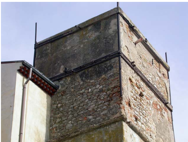
Fig. 3 – Condizione del campanile prima dell'intervento: è visibile l'eterogeneità dell'apparecchio murario, sganciamenti, lesioni e la presenza di catene metalliche di cerchiatura, eliminate a seguito dell'intervento.
