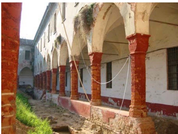
Fig. 7 – Vista del colonnato del chiostro prima dell'intervento sulle colonne.
