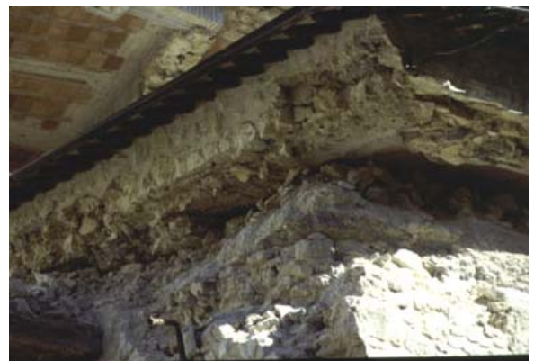
Fig. 3 – Sgretolamento del paramento murario esterno al disotto del cordolo.
