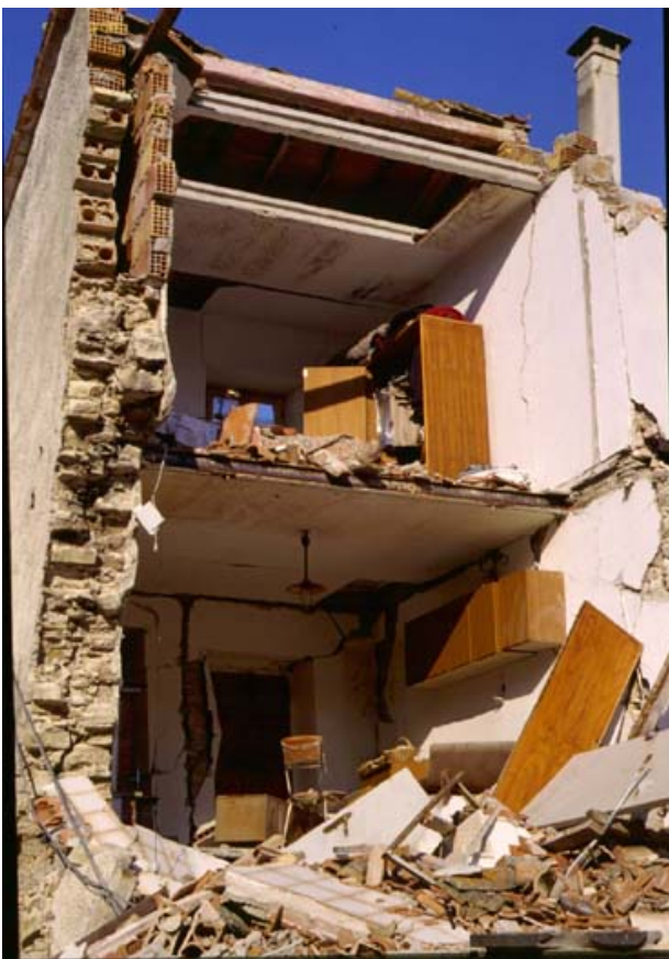
Fig. 1 – Crollo di una parete muraria a doppio paramento (Sellano, 1997).
