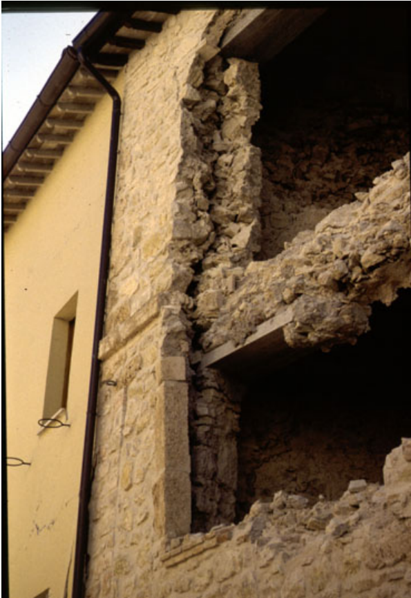
Fig. 2 – Crollo di una parete muraria a doppio paramento (Sellano, 1997).
