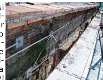
Cordolo tipo GIUFFRÈ, senza necessità di demolire la muratura e la copertura, realizzato con due correnti parallele e collegamenti diagonali. (Sant'Agata Militello ME)
