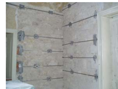
Collegamenti attivi tra setti murari (Vittoria)
