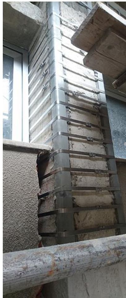
Pilastro in corrispondenza di infissi senza prevederne la rimozione
