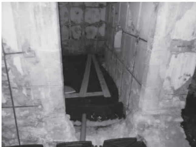
Castello Rivera (AQ) – realizzazione del reticolo con salvaguardia dell'imbotto lapideo. I nastri verticali sono inghisati in fondazione.
