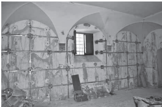
Castello Rivera (AQ) – particolare del passaggio del reticolo con attraversamento delle lunette della volta e salvaguardia del blocco lapideo d'imposta.
