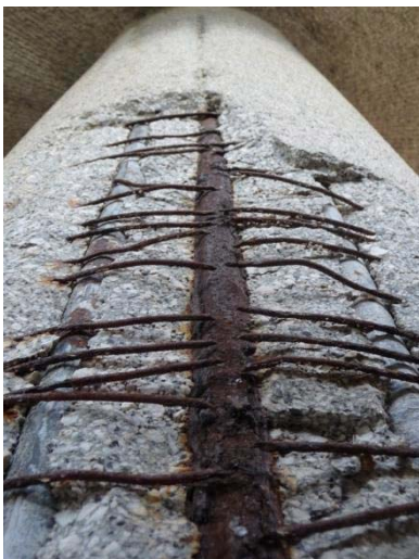
Figura 6. Pilastro "a fungo" del piano pilotis . Deterioramento della cortecchia esterna con ossidazione delle barre longitudinali e della spirale trasversale.
