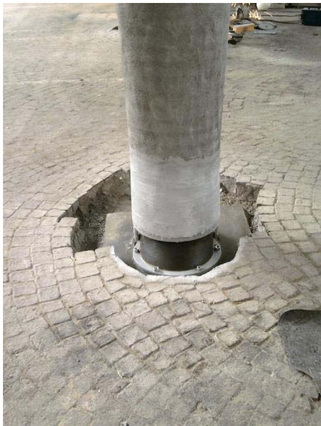
Figura 13. Un pilastro con l'isolatore elastomerico dopo il ritorno elastico alla posizione indeformata.
