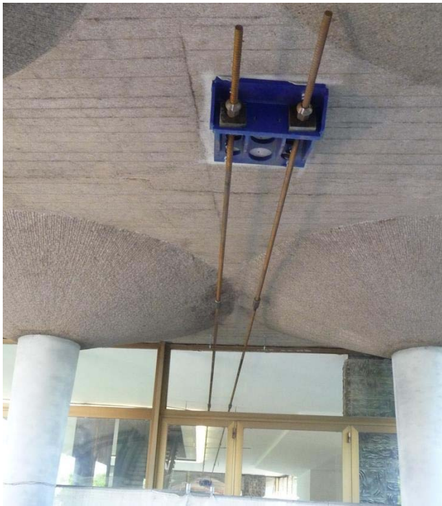
Figura 11. Sistema di tiranti per il rilascio dei fabbricati ancorati alle estremità a carpenterie metalliche di contrasto inghisate all'intradosso del primo solaio.
