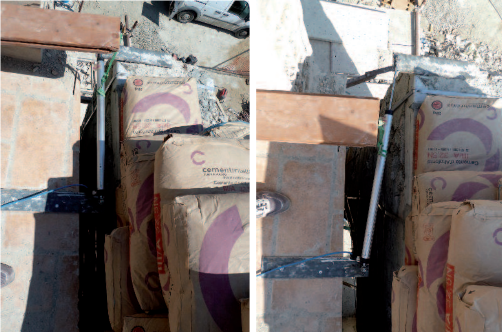
Figura 33 Trasduttore di spostamento in testa al pannello, pre e durante di prove. Oltre a rilevare uno spostamento nel piano dell'arco, si evidenzia un notevole fuori piombo.
