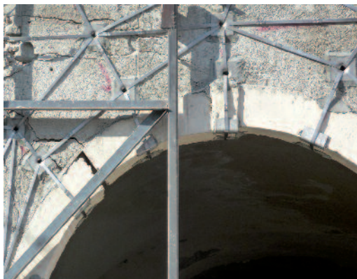
Figura 25 Prova su arco rinforzato: lesione n. 3 e 4, slittamento dell'elemento superiore e fessurazione sezione in chiave (a sinistra).
