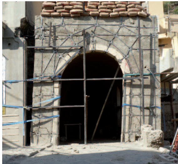
Figura 28 Prova su arco rinforzato danneggiato: danneggiamento durante l'ultimo ciclo di carico.
