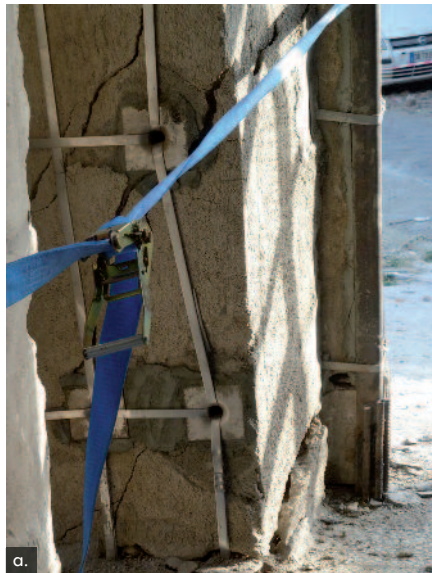
Figura 32 Prova su arco rinforzato danneggiato: rotazione del pedritto di destra a) nel piano; b) fuori piano (a destra).
