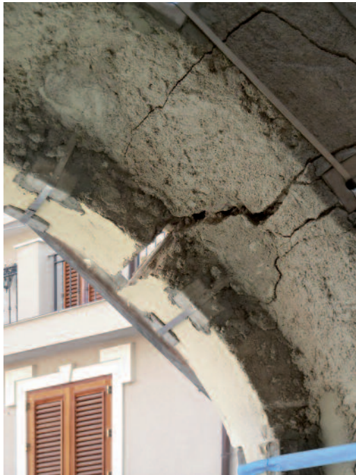
Figura 29 Prova su arco rinforzato danneggiato: apertura lesione nella sezione delle reni (a sinistra).
