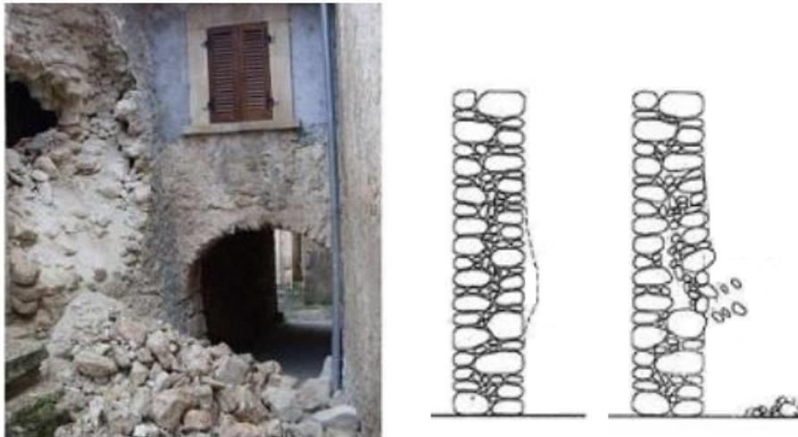
Figure 8 - La rottura per disgregazione dell'apparecchio murario
